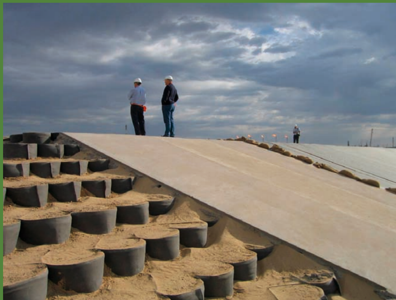
Mur de protection contre les fuites d'hydrocarbure, Kazakhstan
